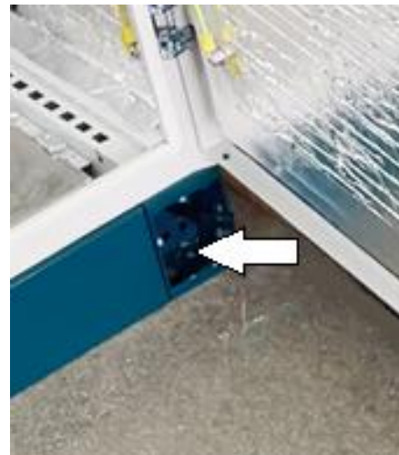
Abbildung 3.4 Einer der vier Verankerungspunkte.
